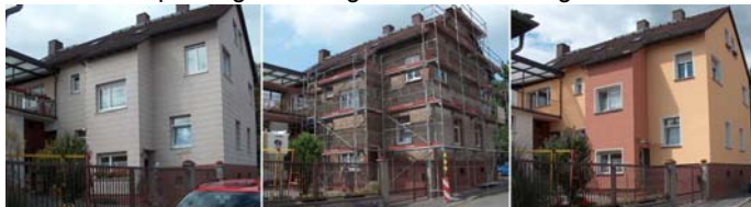
Das Haus in der Wagnerstraße vor, während und nach der Sanierung der Fassade im Jahr 2008
